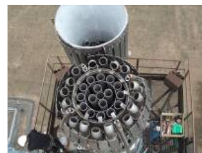
Nouveau nez de la torche lors de son installation en 2005
